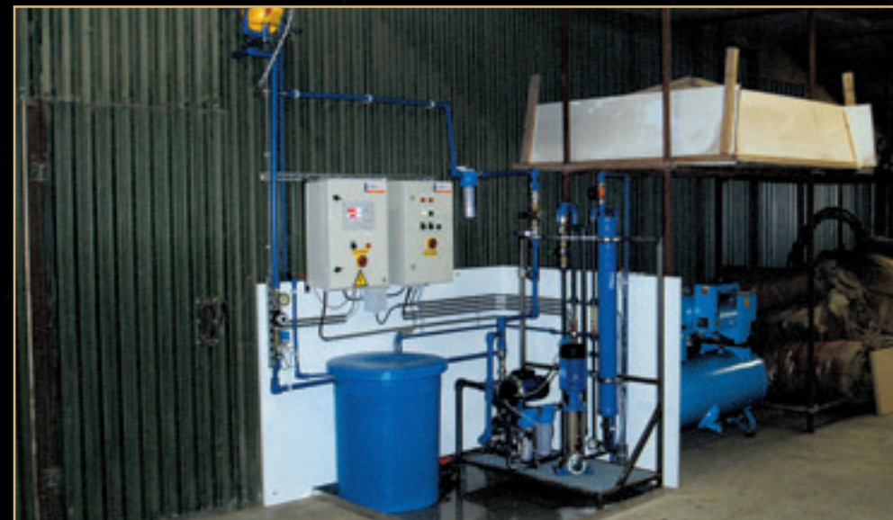
De complete installatie van Climanova voor het bevochtigen van lucht. Op de aanstuuringskast kan de gewenste relatieve vochtigheid (RV) worden ingegeven.
