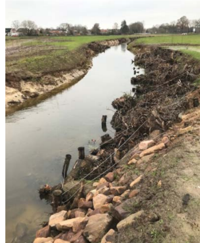
Stobben langs de Dinkel met verankering van houten palen en staaldraad (foto Esther de Jong).
