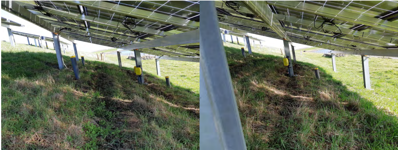
Foto 7. Erosie onder de horizontale kieren tussen de panelen.
