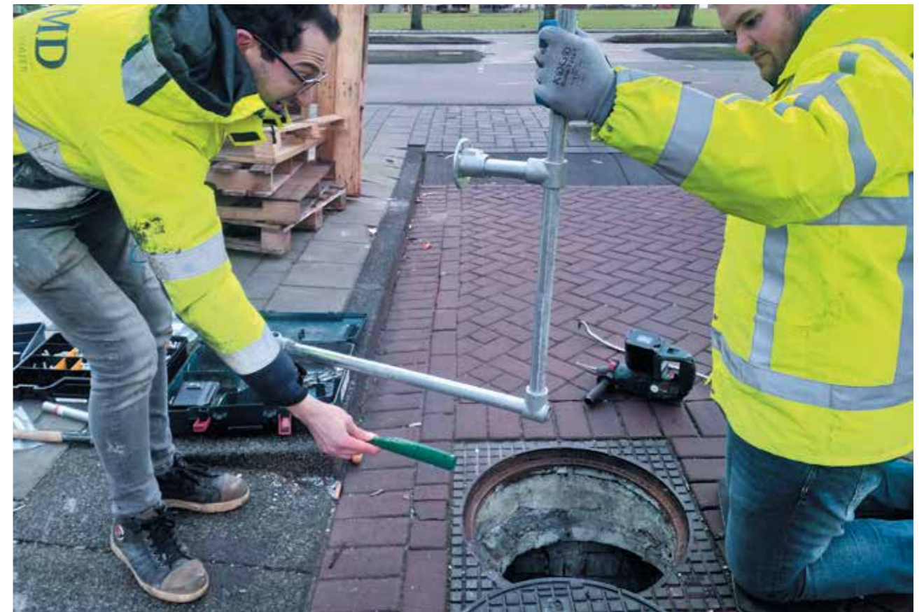
➔ Montagemateriaal passieve sampler voorafgaand aan bevestiging in de rioolput.
