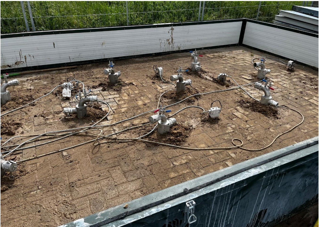
Figuur B1.3 Overzicht vrieslansen en bekabelde temperatuursensoren (Foto TIBACH).
