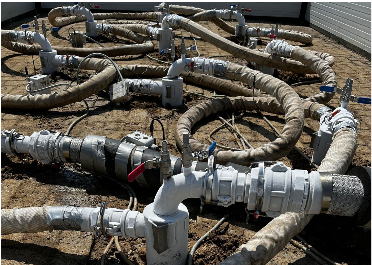
Figuur B1.5 Proefdraaien van de installatie, door afkoeling bevriest condens op de leidingen en vrieslansen (Foto TIBACH).
