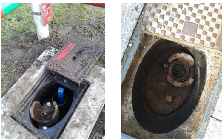
Figuur 4 In beide gevallen komt de klauw met de straatpot in contact. In de linker foto is de brandkraan nog wel plaatsbaar, in de rechterfoto is dit niet mogelijk (bron: Evides Waterbedrijf).
