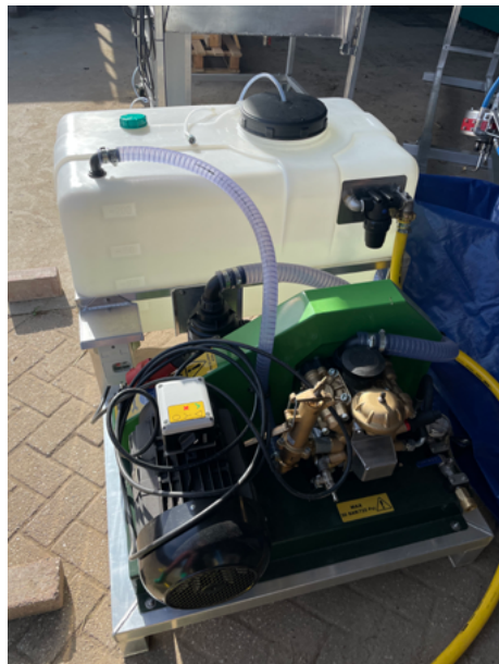
d. Aandrijving hogedrukspuit opstelling, voorraad demiwater met pompsysteem
