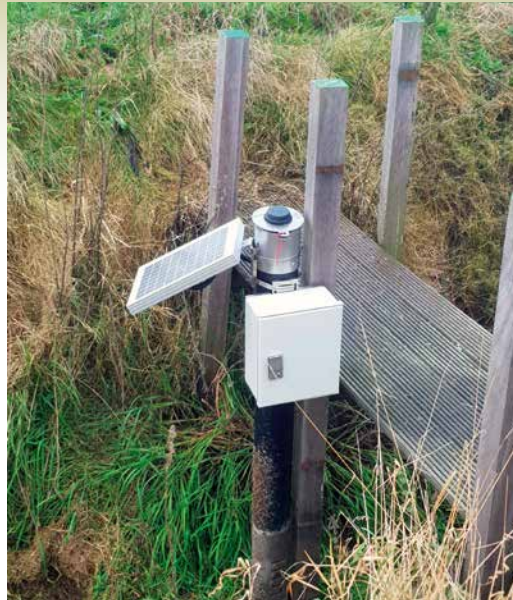
Aeres Hogeschool heeft sensoren voor elektrisch geleidingsvermogen, pH, redoxpotential, temperatuur en zuurstofgehalte aan het begin en het einde van de helofytensloot geplaatst
