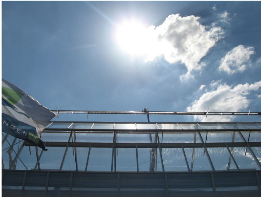
Figuur 6.2. Foto van de totale watergekoelde PV module gemonteerd aan de beweegbare armen.
