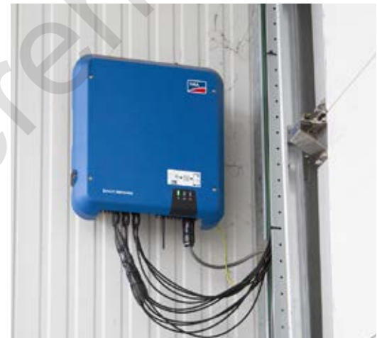
Deze 'omvormer' zet de gelijkstroom van de panelen om in wisselstroom voor het net.
