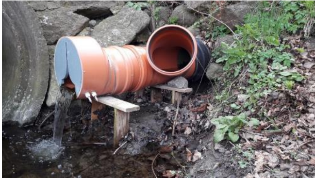
Figuur B7.3 Flowcap geïnstalleerd aan een verzameldrain voor het meten van vrachten.
