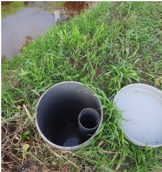
Figuur B1.11 Regelbare drainageput met afvoer naar de Vinkenloop met hoge nitraatconcentratie in de routing van 10 februari 2022.
