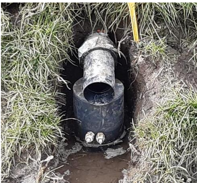
Figuur B7.4 Flowcap geïnstalleerd aan individuele drain op een perceel in de Vuursteentocht.
