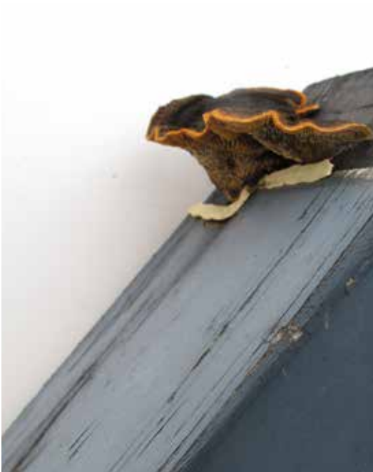
Vruchtlichaam van plaatjeshoutzwam op proefkozijn. Foto: SHR
