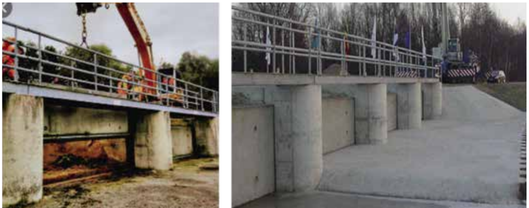
Afbeelding 2 Het complex van inlaatschuyven voor het vullen van het noodretentiegebied (links: oefening van waterschap Vechtstromen, rechts: overzichtsfoto)
