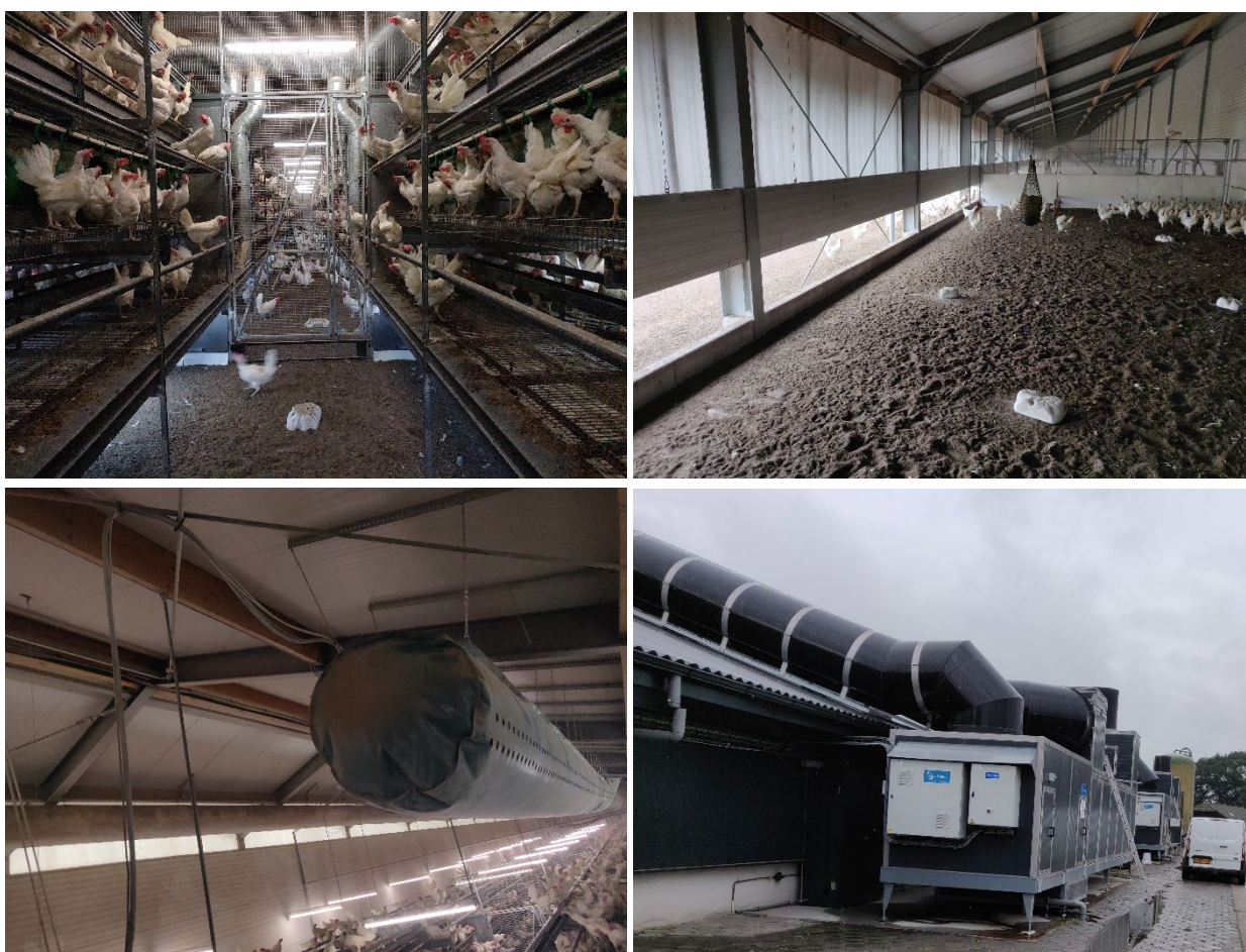
Figuur 2.1 Linksboven: volièrestal met mestbandbeluchting; Rechtsboven: wintergarten; Linksonder: luchtinlaatslang; Rechtsonder: ECO Unit.
