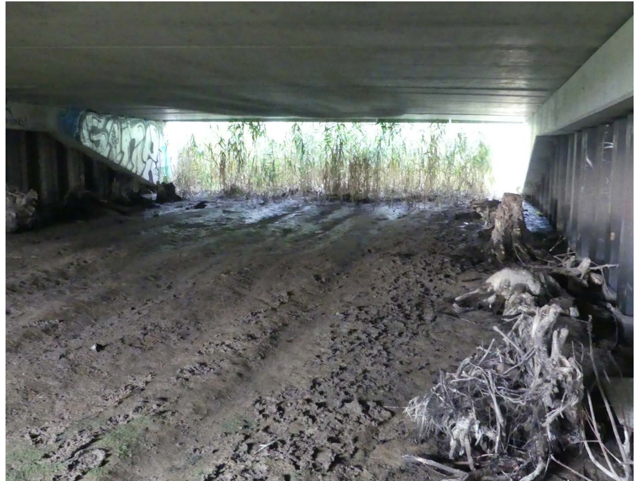
Figuur 7 Faunapassage Crone- steyn, westelijke tunnel. Binnen- in is de tunnel kaal en modderig, met rijen boomstronken langs beide zijden.
