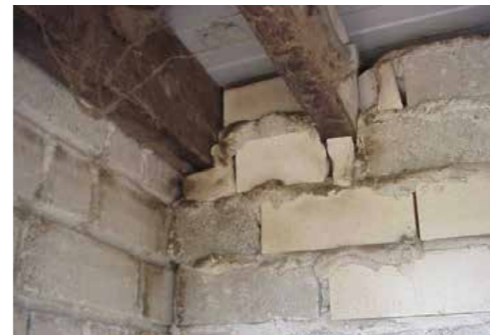
Buiksmeersporen op bakstenen en cement.
