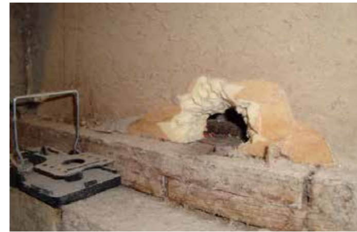
Knaagschade aan isolatie door rat met bijgeplaatste klem.
