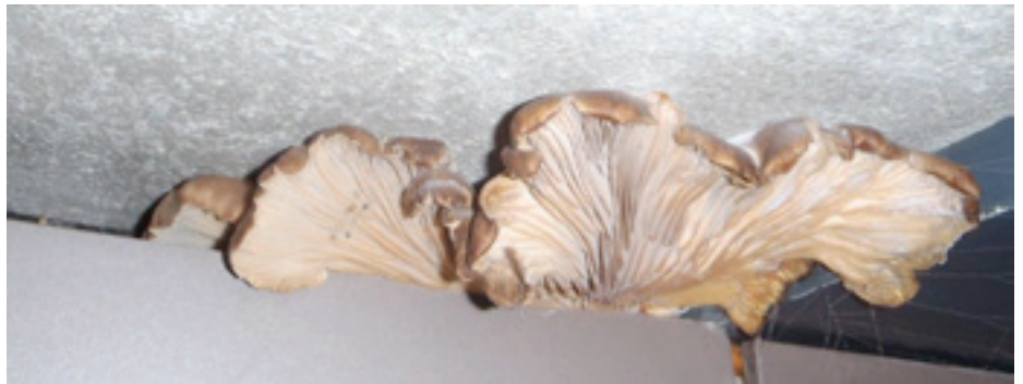
Oesterzwammen die uit het plafond groeien. Foto: Lamon Bedrijfshygiëne B.V.
