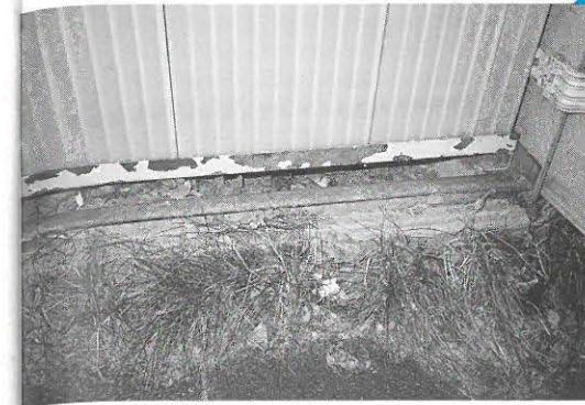
rubber afdichting over een lengte van enkele centimeters weggeknaagd
