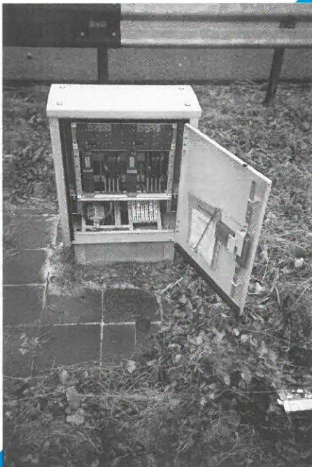
regelkast met schade door muizen
