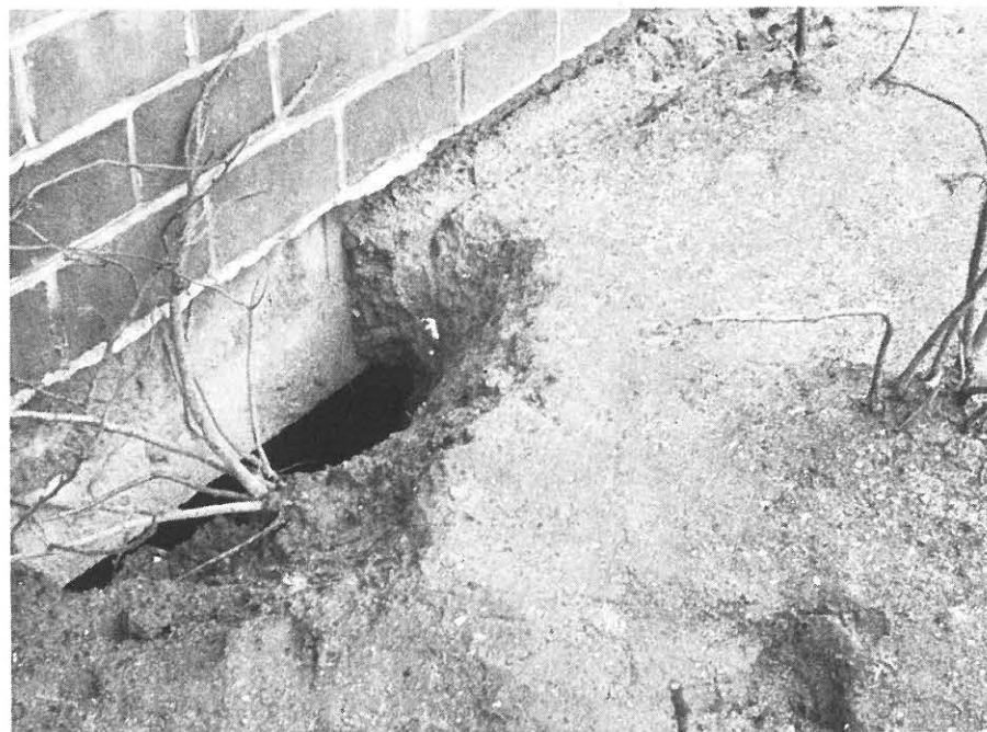
Verzakking bij doorvoeropening van waterleiding door rattenholen.
