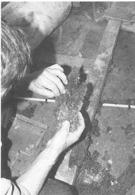
schade aan drukvilt-geluidsisolatie door kleermot (foto Retham - Zwolle)
