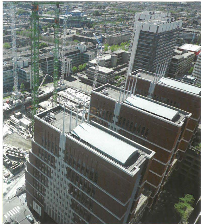
Foto door Albert Weijman gemaakt vanaf de 29e verdieping van het Ministerie van Onderwijs. In de diepte de fundamente van de nieuwe hoofdzetels van de ministeries van Justitie en van Binnenlandse Zaken en Koninkrijksrelaties.
