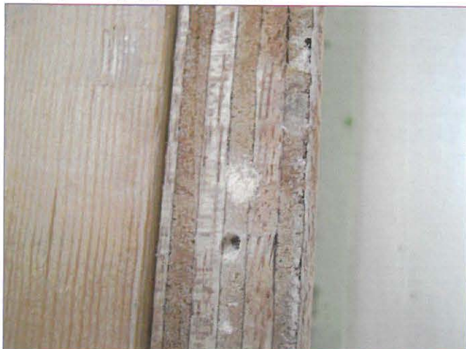
Multiplex plaat met gang gevuld met boormeel.
