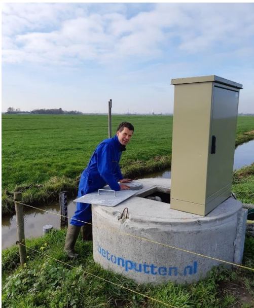
Figuur 3.15 Waterreservoir waar de onderwaterdrains op aangesloten waren en met pompen het streefpeil voor de grondwaterstand kon worden gerealiseerd. In de kast die op de put was gemonteerd bevond zich het besturingssysteem voor het instellen van de streefpeilen en het aan- en uitschakelen van de pompen voor draineren en infiltreren.
