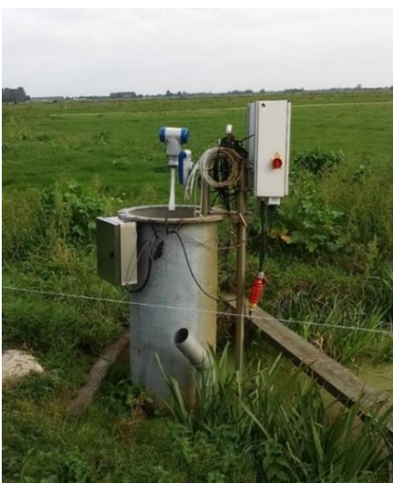
Figuur 3.11 Opstelling waterreservoir met pomp en automatische hoogtemeting van het waterpeil in het reservoir voor de toepassing van drukdrains. De drainbuizen waren via een verzameldrain op het reservoir aangesloten.
