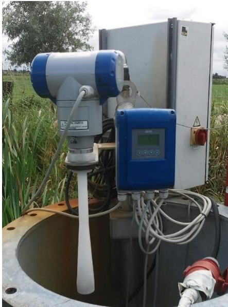
Figuur 3.14 Ultrasoonsensor (de witte naar beneden gerichte pijp) voor het meten van het waterpeil in het waterreservoir.
