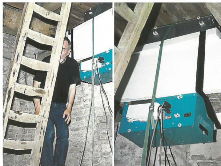
De 2e verdieping van de 14-eeuwse kerktoren. Zowel boven, als onder de balk is een microgolfgenerator geplaatst. Deze heeft een vermogen van 1000 Watt. Via de antenne wordt dit verdeeld in 5 x 200 Watt. Om straling van golven te voorkomen, is aluminiumfolie aangebracht.
