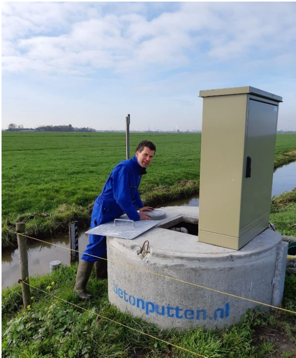
Figuur 2.7 Waterreservoir waar de onderwaterdrains op aangesloten waren en met pompen het streefpeil voor de grondwaterstand kon worden gerealiseerd. In de kast die op de put was gemonteerd bevond zich het besturingssysteem voor het instellen van de streefpeilen en het aan- en uitschakelen van de pompen voor draineren en infiltreren.
