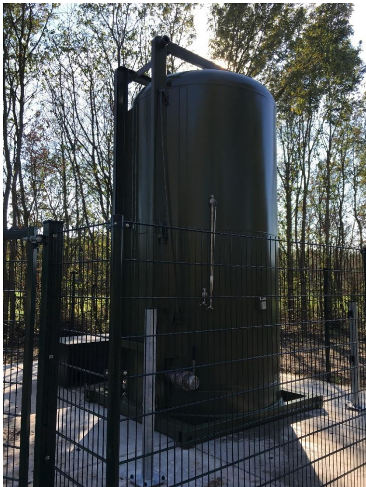
Afbeelding 1. Mobiel actiefkoolfilter op het anaerobe grondwater van bron 40
