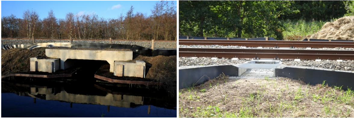
Figuur 3 Twee van de faunapassage in de spoorlijn die het Naardermeer doorsnijdt. © Foto's: Edgar van der Grift (links); Fabrice Ottburg (rechts).
