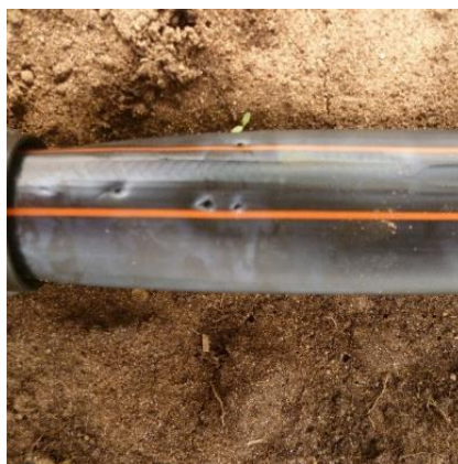
Figuur 22. Schade door vogels
