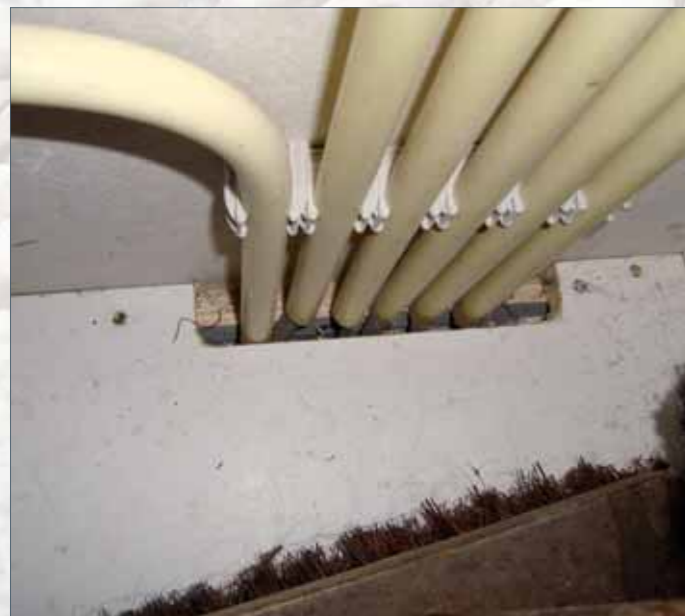
Doorvoeropeningen voor leidingen bieden plaagdieren toegang tot andere ruimtes.
