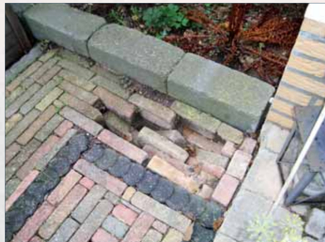
Gebreken aan de riolering kunnen ratten toegang verschaffen tot een gebouw.
