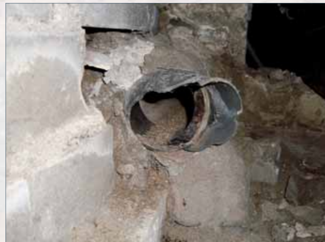
Deze openstaande rioleringsbuis verschaft plaagsoorten gemakkelijke toegang tot een woning.
