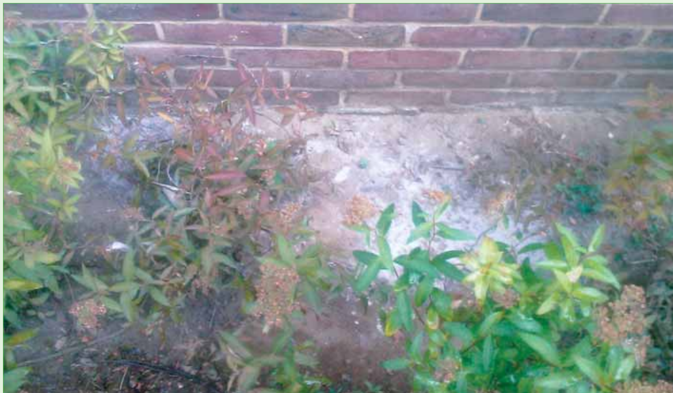
Poeder langs de gevel van de kinderopvang op 10 augustus 2010. Foto: Ronald Gylstra.
