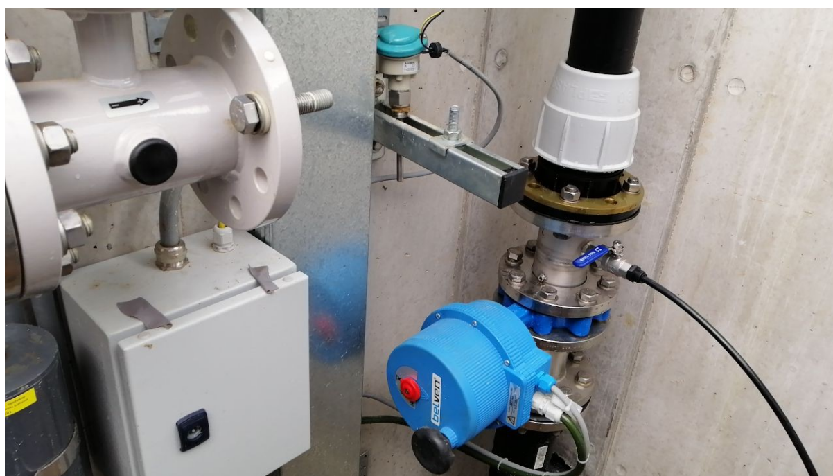
Figuur 4.4. Aansluiting troebelheidsmeter (zwarte buisje) bij W7 voor het filter
