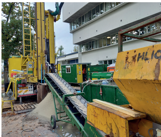
Afb. 7: Het boorgat wordt aangevuld met zand of micoliet afhankelijk van de laag.
