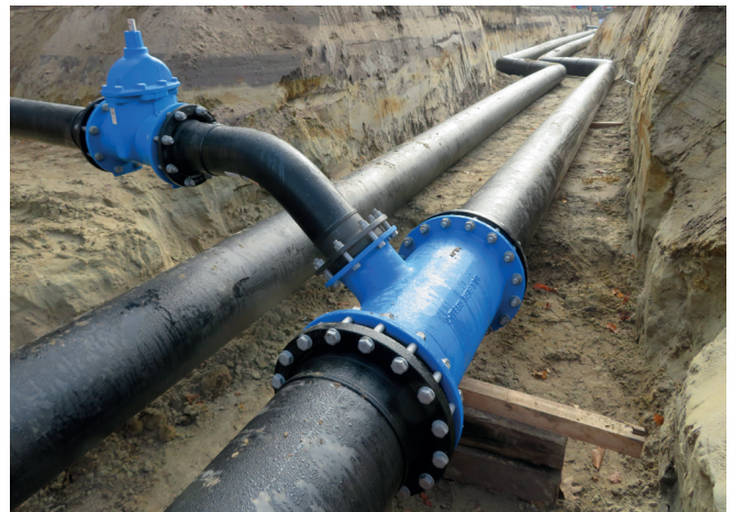
Afb. 8: Aftakking met afsluiter
