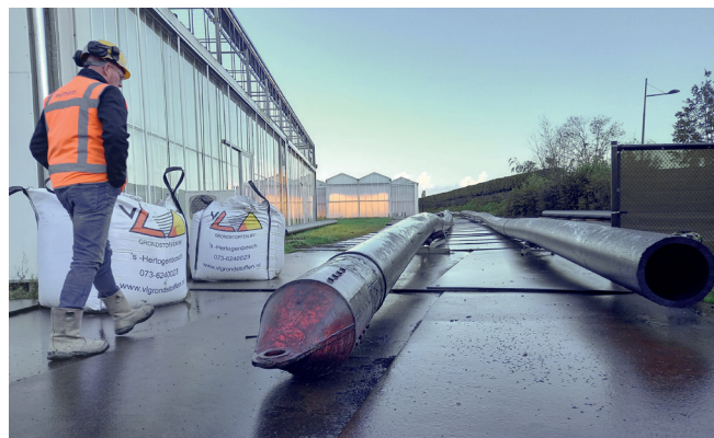
Afb. 5: Langs de kassen van Radix Serre liggen twee 450 mm-leidingen van 300 m klaar op rollertjes om ingetrokken te worden; de linker leiding is voorzien van een trekkop.
