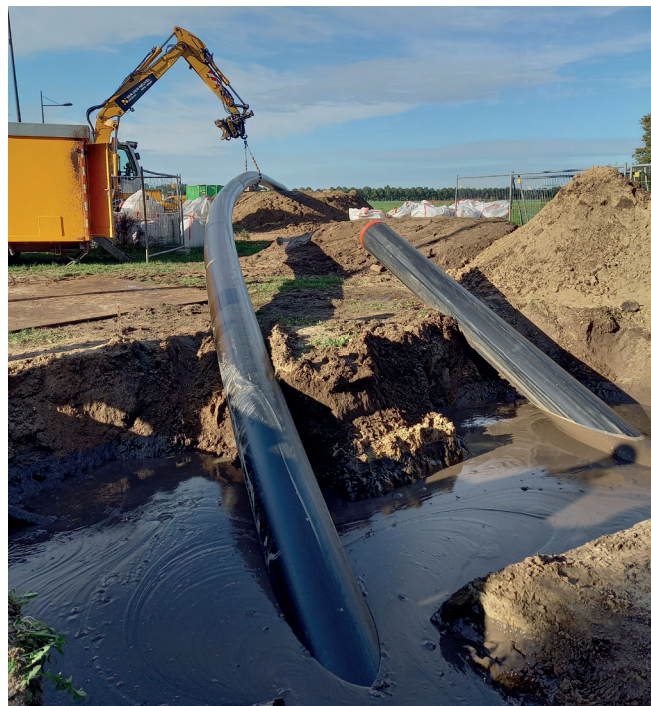
Afb. 6: Tijdens het intrekken wordt de leiding begeleid door een kraan, om zo wrijving te beperken
