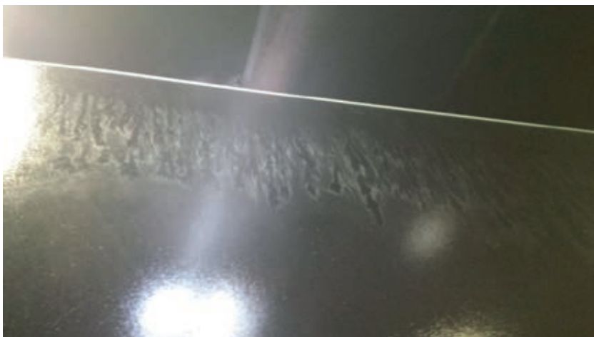
Figuur 2 Voorbeeld van corrosie tijdens opslag van glas (niet het glas uit dit project)
