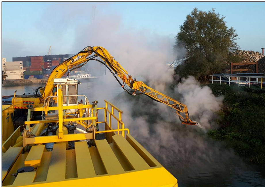
Figuur 24. . 27 september 2017. Proef met heet water in de Werkhaven. (Foto Hebo)
