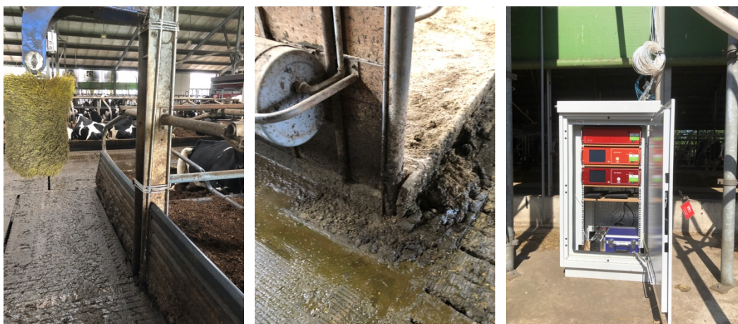
Afbeelding 2.1 De linker en de middelste foto laten een voorbeeld zien hoe de meetleidingen onder de vloer gaan. De rechtse foto laat een voorbeeld van de apparatuur zien, die buiten in een geïsoleerde kast staat.
