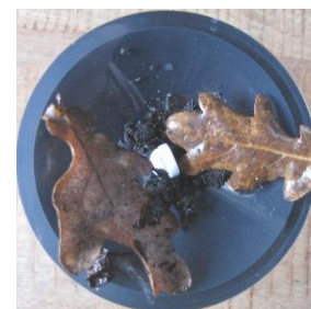
Fig. 5 vuil in opvangopening
