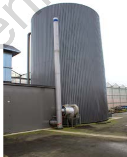
Het buffervat van 750 m 3 dat als opslag van reservewarmte dienst doet.
