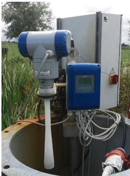
Figuur 2.5 Ultrasoonsensor (de witte naar beneden gerichte pijp) voor het meten van het waterpeil in het waterreservoir.
