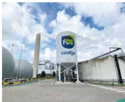
Fos Vaatje, de struvietinstallatie op de rwzi Amsterdam-West
