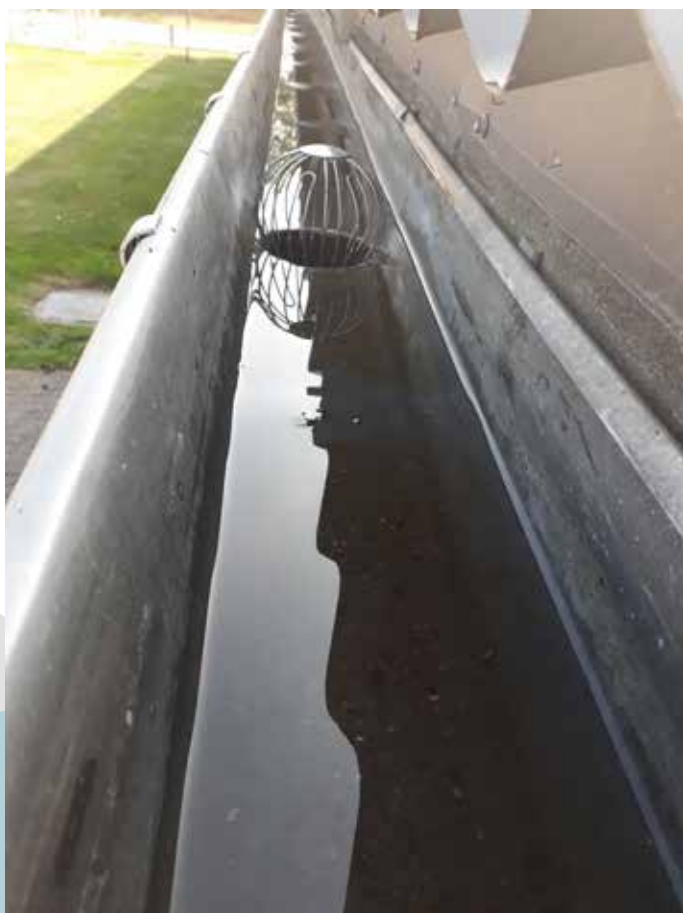
Foto 3: Reinig regelmatig de dakgoten om vervuiling van de regenwateropvang te voorkomen.
