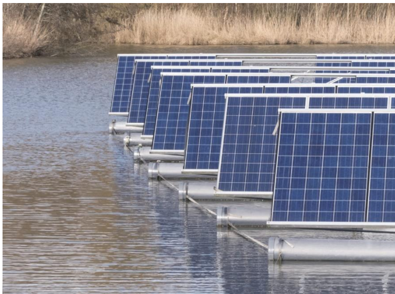
Drijvende zonnepanelen op een drinkwaterwingebied
