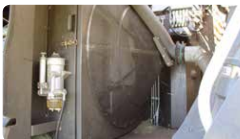
De ventilator verzamelde te veel stof, waardoor eerst een extra afzuigslang is gemonteerd en later een variabele ventilator.
