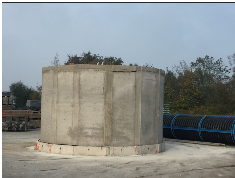
Figuur 5 Betonnen anker voor de Slow Mill-pilotinstallatie. Bron: Slow Mill Sustainable Power BV
