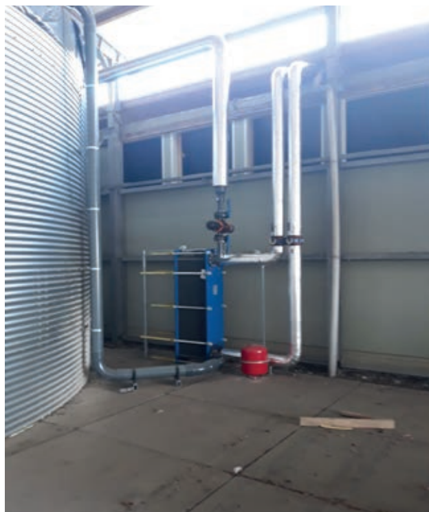
Foto 2 Silo met warmtewisselaar.
