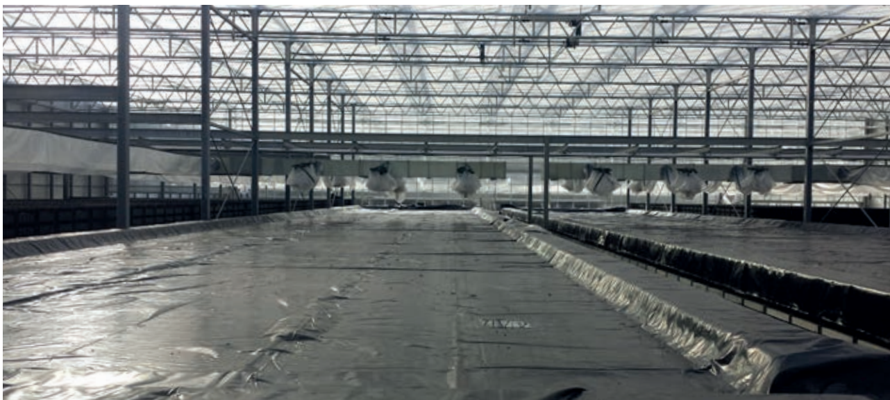
Foto 3 Overzicht van een afgedekte collector. Het water stroomt onder de afdekkende plasticfolie van achteren naar voren.
