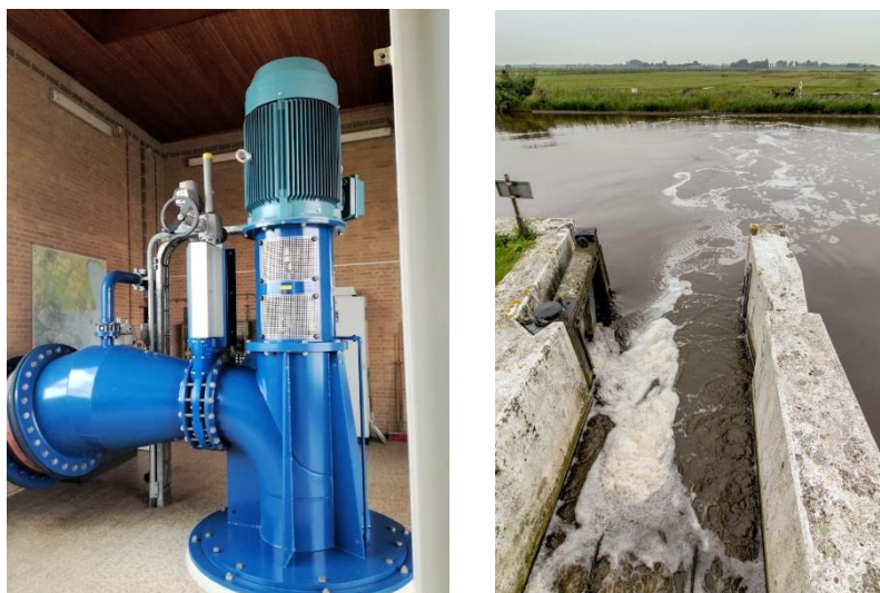
Figuur 14.4 (links) Locatie 531002. Een van de pompen in het gemaal Wijd Wormer (Foto: Herman van Dam).
