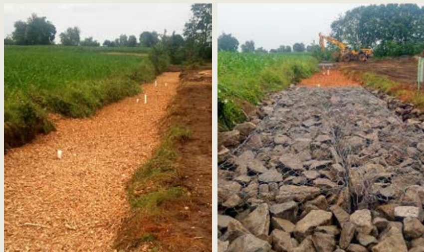
Aanleg van de bioreactor in juni 2018. De houtsnippers worden gestabiliseerd met keien.
