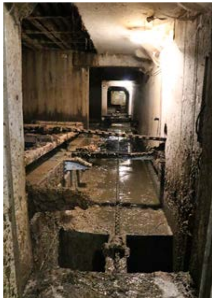
De aandrijving van de mestschuif is identiek aan een mestschuif in de rundveestal.
