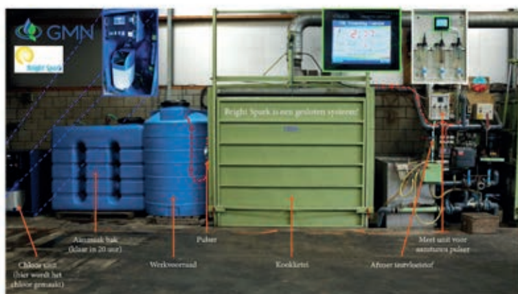
In het Bright Spark/Akerboom/GMN-systeem wordt het chloorniveau automatisch op peil gehouden. De lucht rondom het systeem wordt afgezogen, zodat het personeel niet blootgesteld wordt aan eventuele chloordampen
