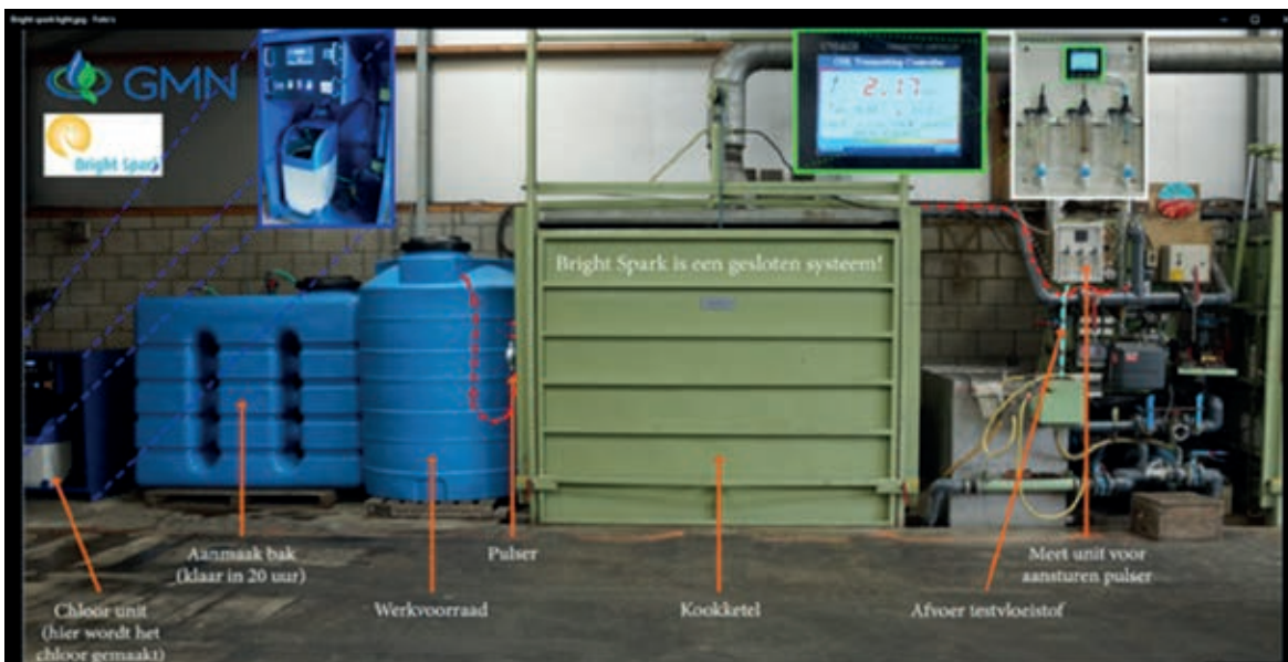
Figuur 4 De complete installatie voor de bereiding en toepassing van ECA water op een bollenbedrijf.
